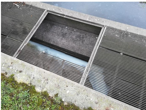
Løse riste. Tilstrømning af hvidt uklart vand
