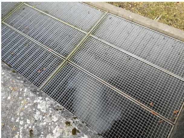
Sparebassin med befæstede riste. Tilstømning af hvidt, uklart vand
