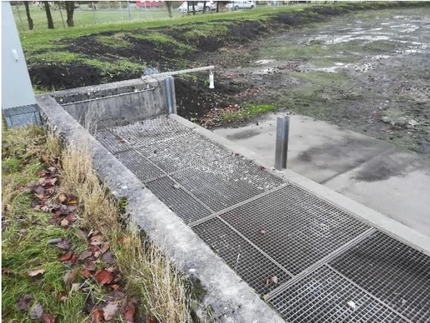
Sparebassin med rist og niveaumåler
