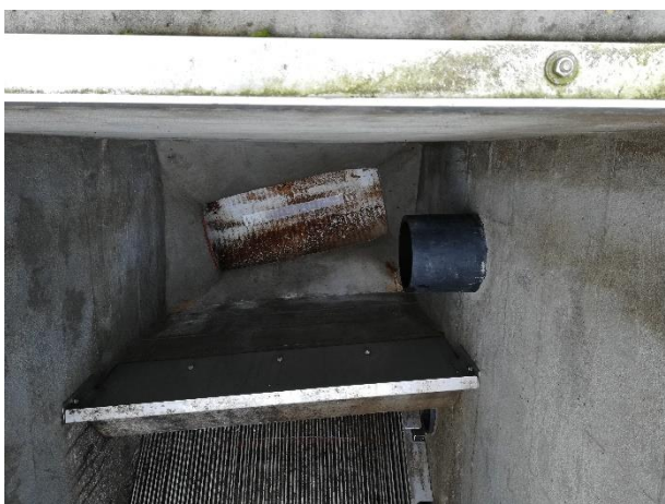
Bygværk med rist og udløbsrør
